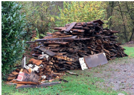
Überreste der Sanierung
